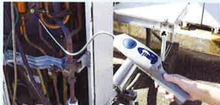
電子式漏れガス検知器で漏れを確認
