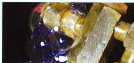
発砲液で漏れを確認
