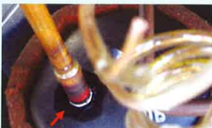
油漏れやしみて漏れを確認
